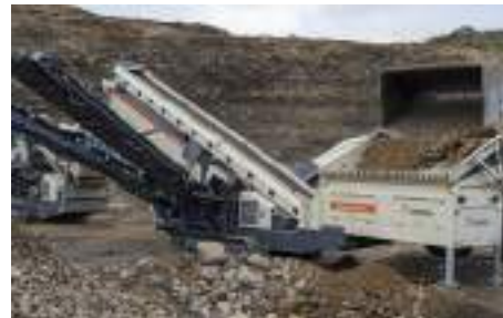
La grande boîte d'alimentation permet un process en circuit fermé.
